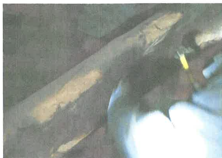
Fot. 5. Porażona powierzchnia ramy (przy wieży)
