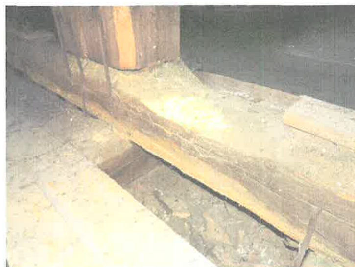
Fot. 3. Zdegradowana powierzchnia belki podwalinowej, klamry stalowe łączące podwalinę z belkami stropu i słupami;
