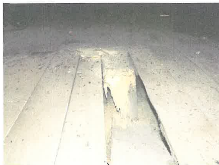
Fot. 2. Zdegradowane deskowanie podłogi na strychu
