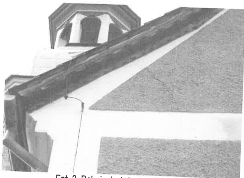
Fot. 2. Pęknięcie ściany szczytowej
