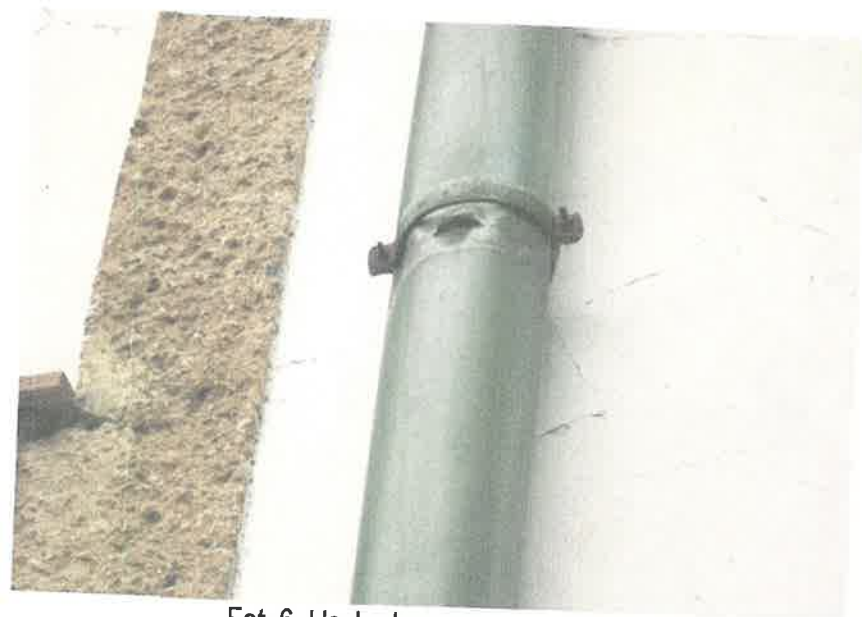
Fot. 6. Uszkodzona rura spustowa
